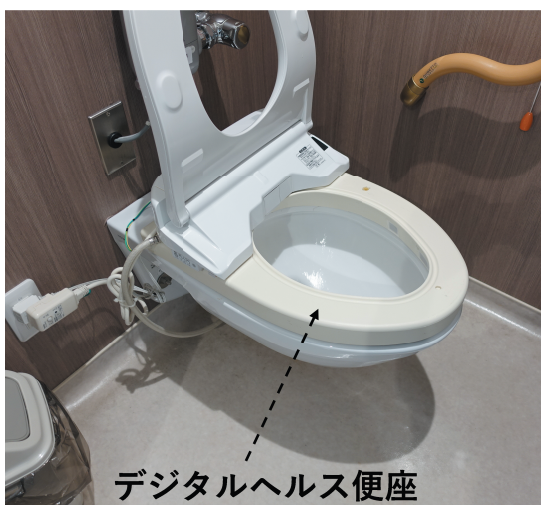
図2 病棟個室トイレに設置されたデジタルヘルス便座
